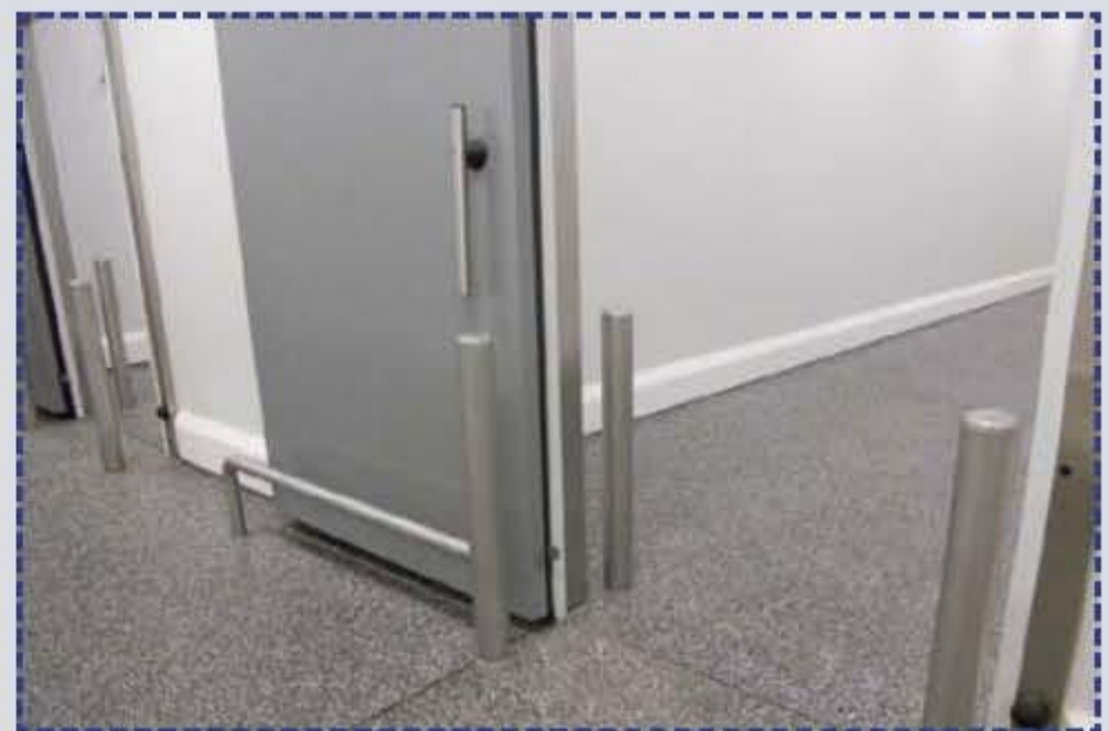
PolySto barrera y postes de seguridad en Acero Inox introducidos en suelo y OP30RB Sanicoat con rebaje aplicando el suelo de granito a la moldura del Zócalo.
