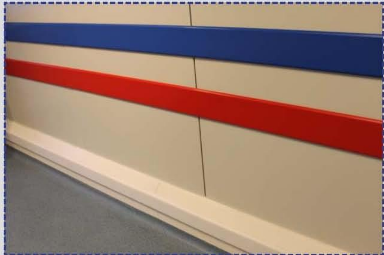
PolySto OP30RB (opcional extremo impacto) con suelo de epoxy aplicado en zócalo con rebaje y bandas PE rojas y azules.
