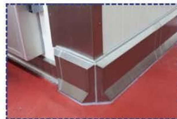
PolySto OP20F en Acero Inoxidable instalado en suelo de epoxy.
